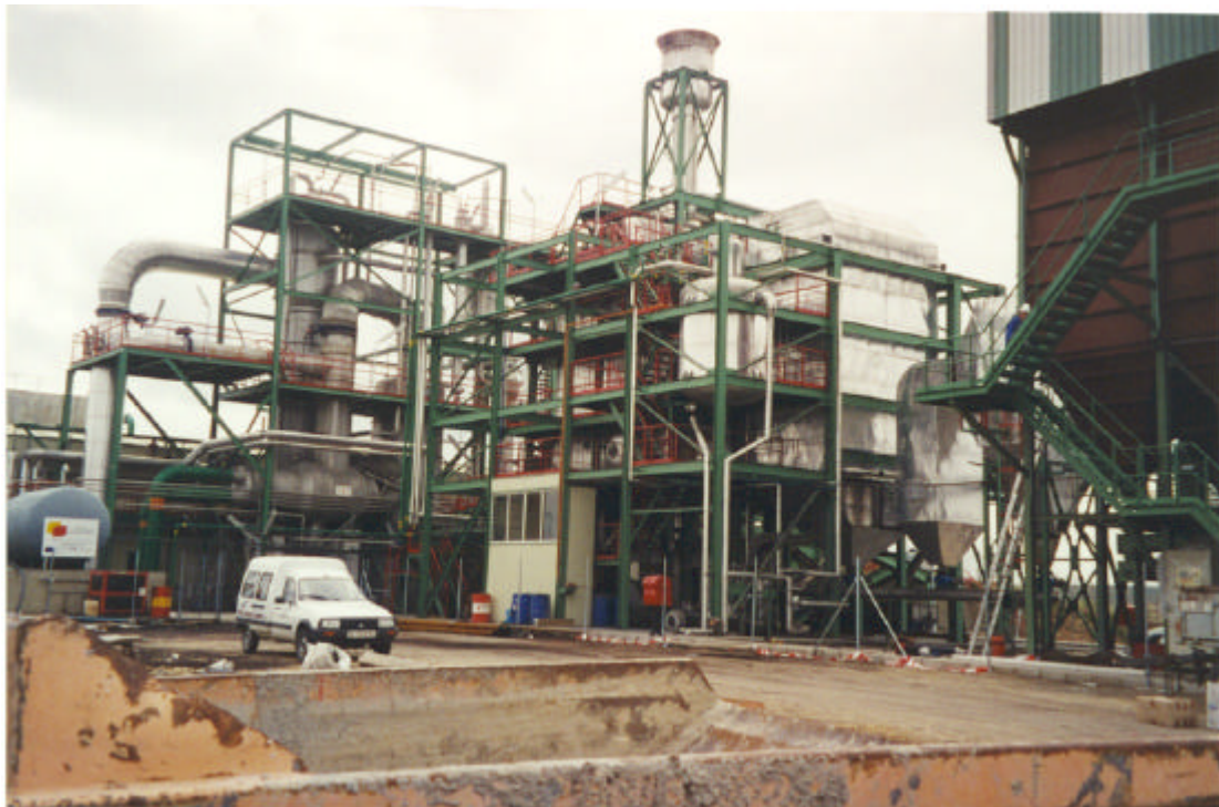
Oleícola El Tejar – Vetejar Electric cogeneration plant
