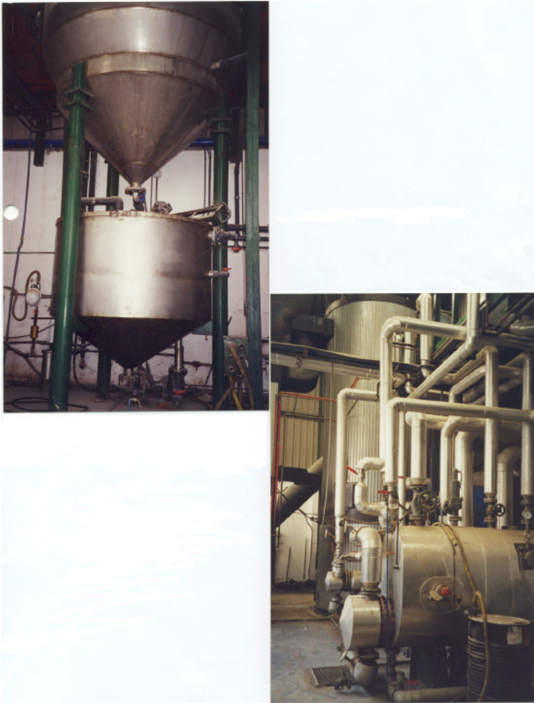
Installation de concentration thermique des margines à Trainalba, SA Flocculation –décantation (première photo) Chaudière et évaporateur (seconde photo)
