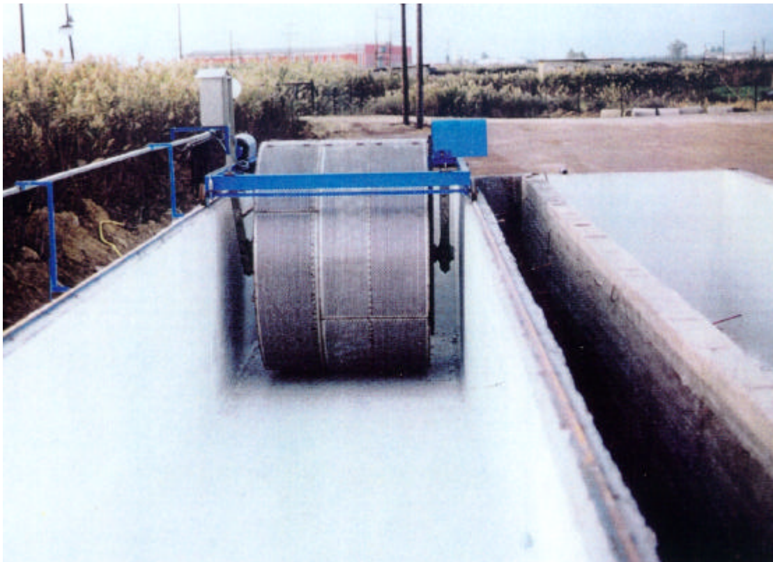
Installation à Kalamata, Grèce (Projet Life 1995). Vitesse de rotation : 6 rpm. Vitesse linéale : 1.8 m/min . Longueur du bassin : 25 m. Capacité : 100 m 3
