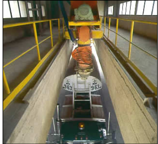
Figura 3.2.80. Sistema de carga de cemento a granel.
