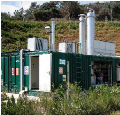
Usine de traitement du biogaz
