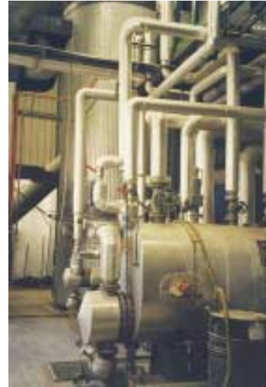
Caldera i evaporador
