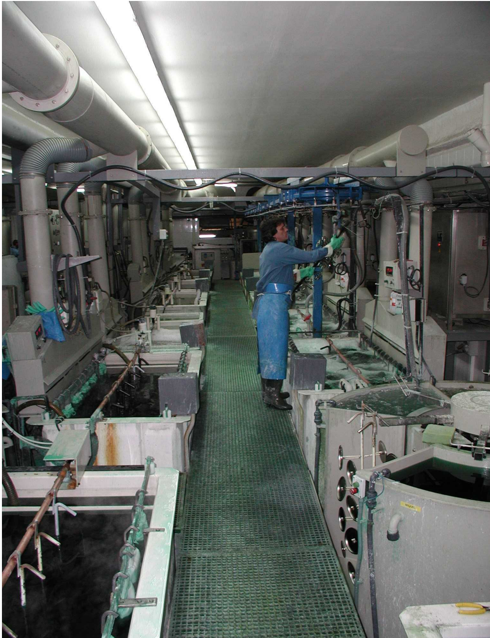
12 - Vista general del corredor con bandejas de recogida de goteos a tierra.
