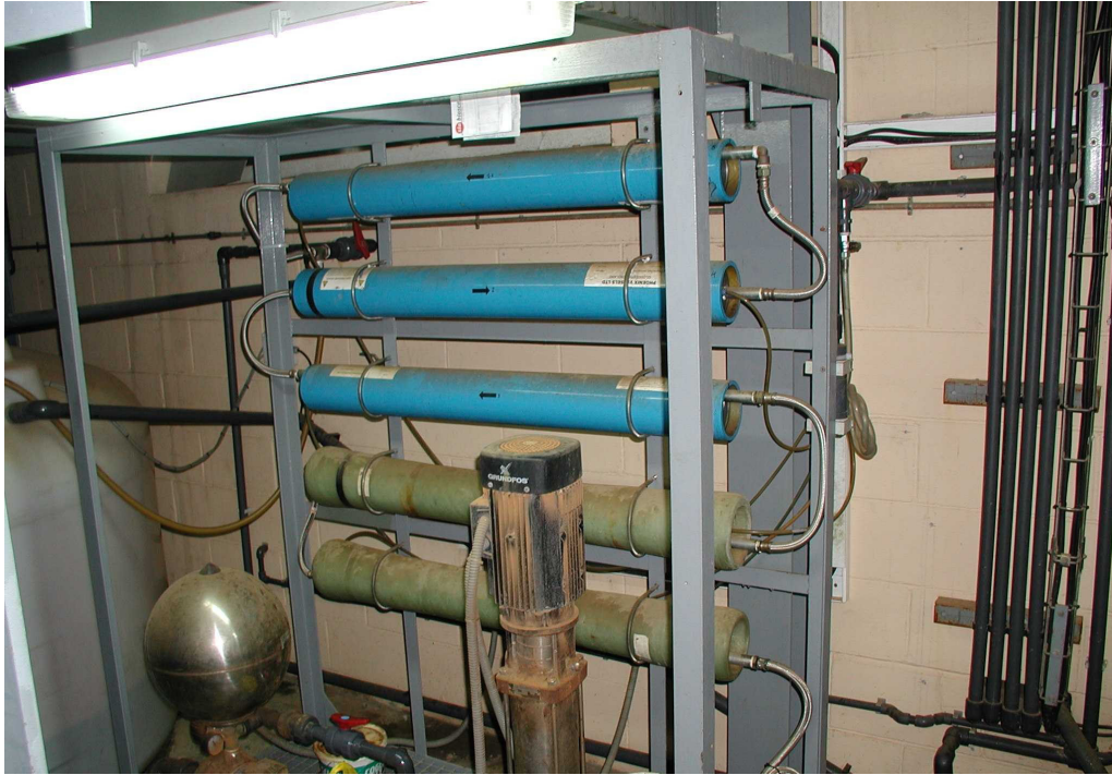
6 – Ósmosis inversa para agua de red.
