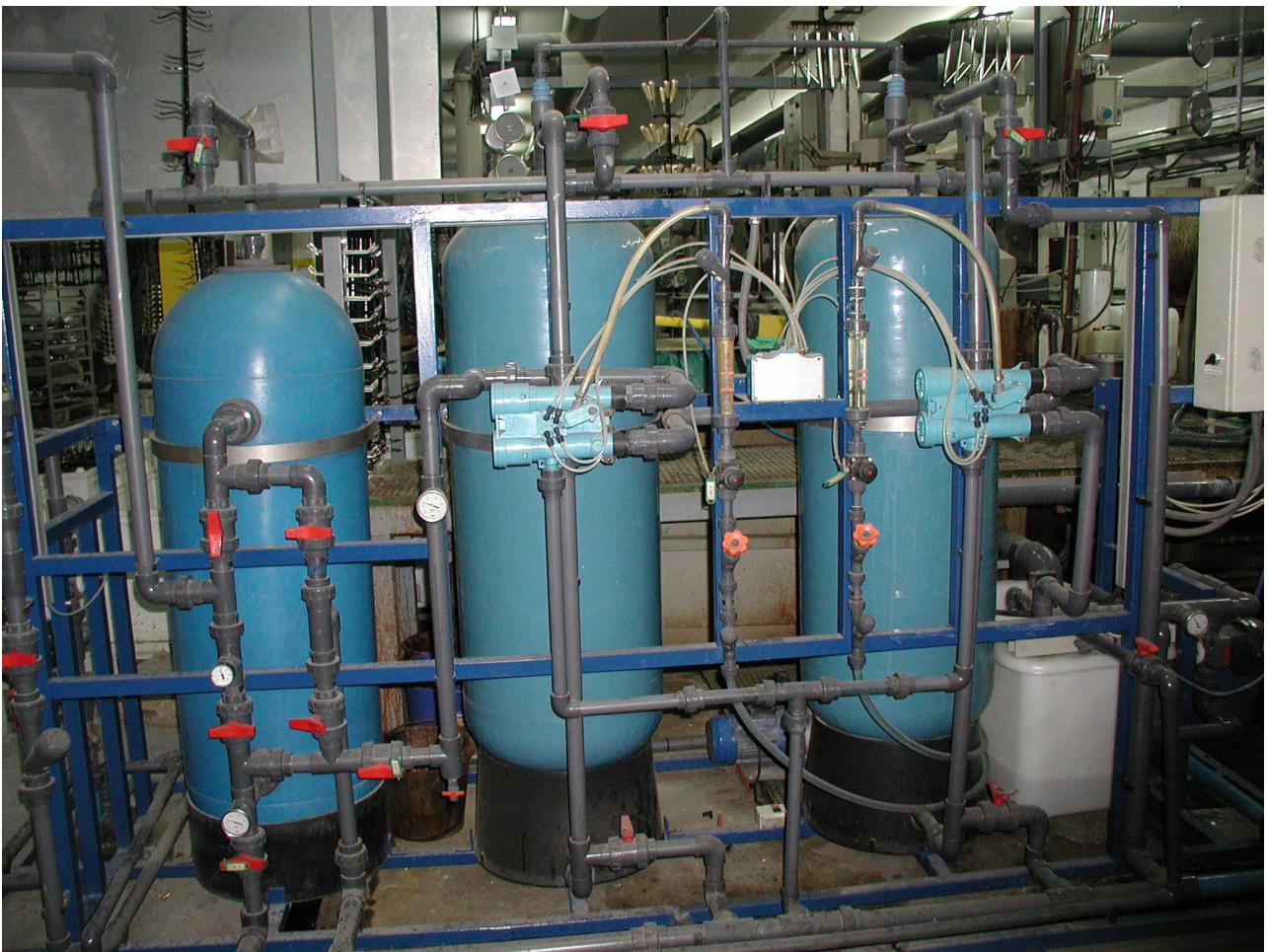
1 - Equipo de reciclaje de aguas de lavado con resinas de intercambio iónico.
