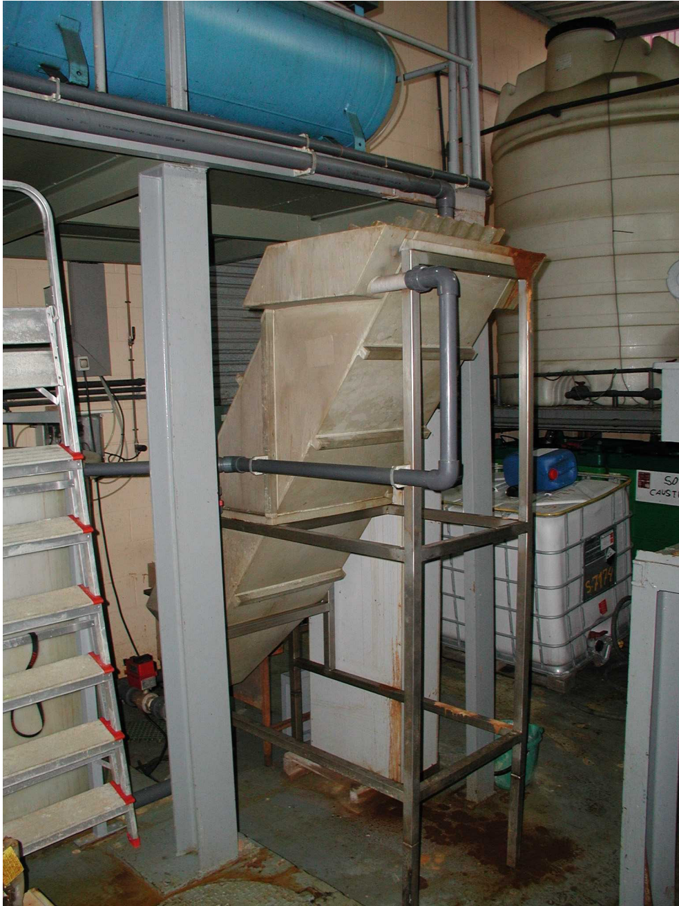
9 – Sedimentador de lamas para concentrar contaminantes antes de la evaporación.
