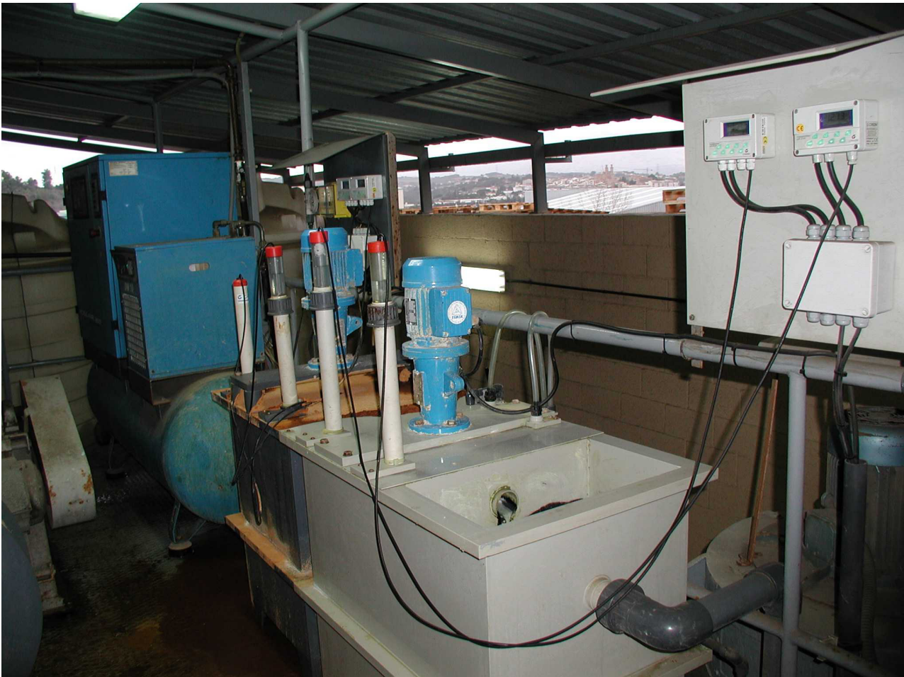
8 – Instalación de oxidación de cianuros antes de la evaporación de agua residual.
