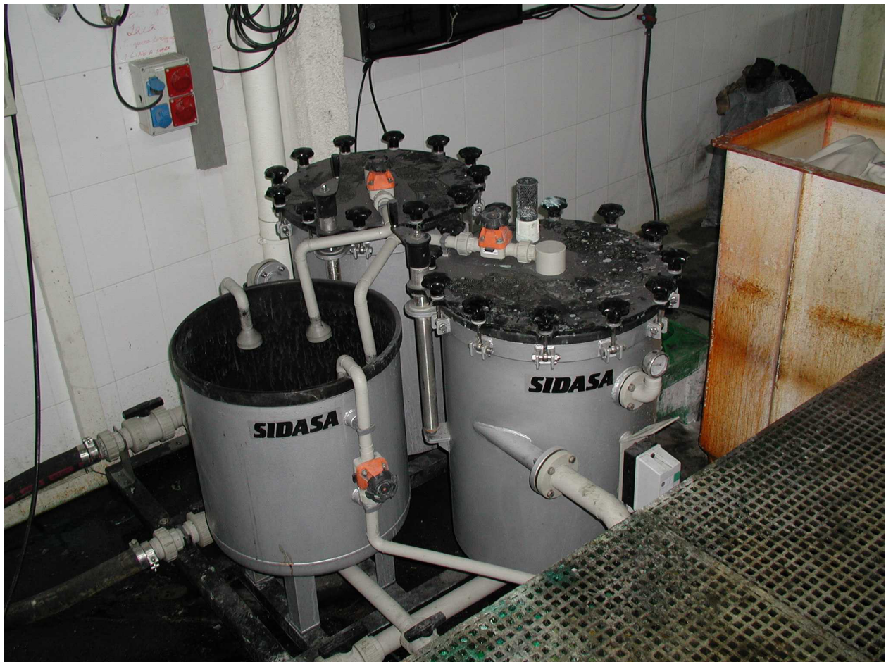
10 – Équipement de filtration des bains.
