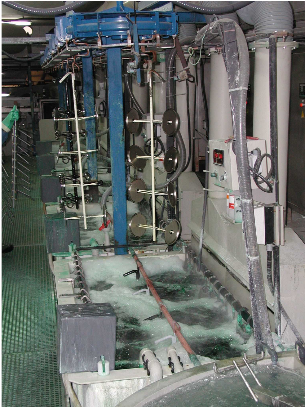
11 – Aspirations des fumées pour bains au nickel.
