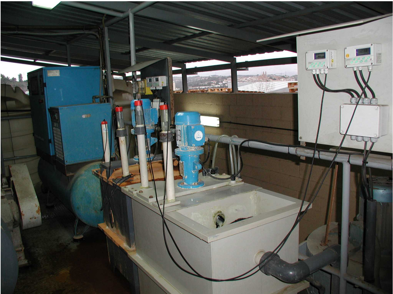
8 – Installation d'oxydation de cyanures avant l'évaporation des eaux résiduelles.
