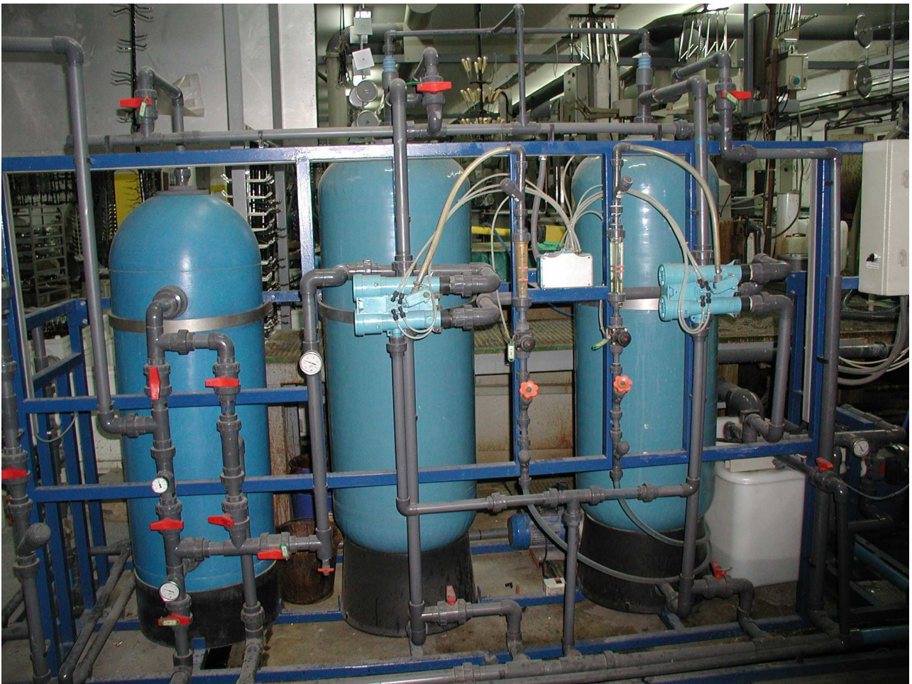
1 – Équipement de recyclage des eaux de lavage avec résines d'échange ionique
