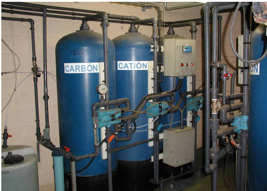
7 – Déminéralisateur d'eau du réseau.
